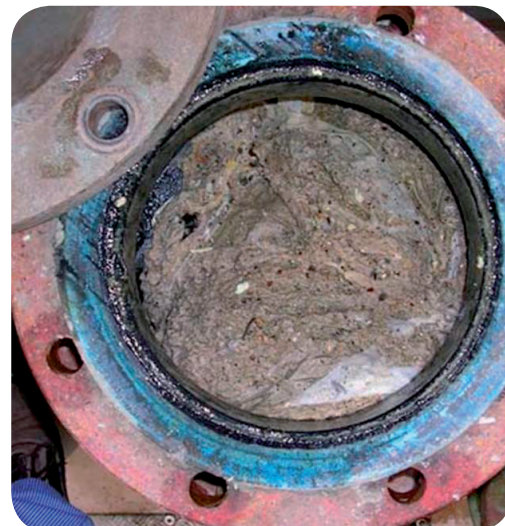
Accumulation de lingettes dans les canalisations
